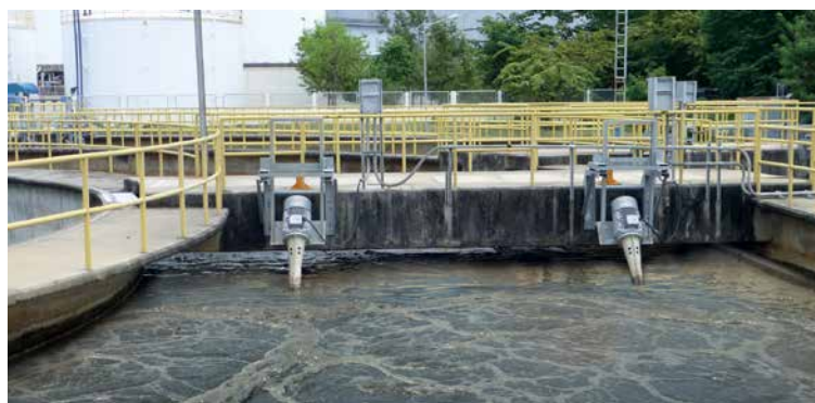
Tanque de lodos ativados de uma estação de tratamento de efluentes industriais (Tailândia)
