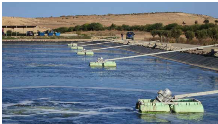
Aeradores OxyStar® sobre flutuadores em uma lagoa de tratamento de efluentes (Marrocos)
