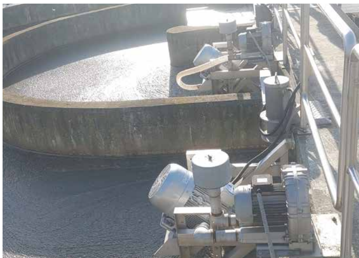
Canal de oxidação de uma estação municipal de tratamento de esgoto (República Tcheca)
