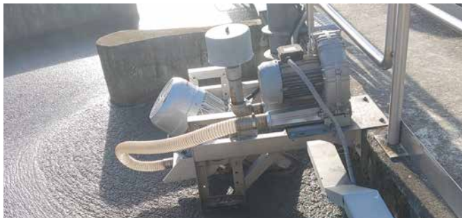
Aerador DualStar montado em uma ponte operacional por meio de suporte de fixação
