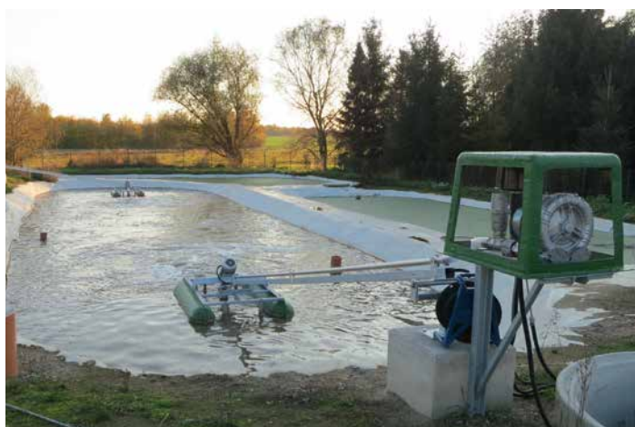
Aerador DualStar com compressor instalado na margem, em uma estação de tratamento de efluentes de uma fábrica de queijos (Alemanha).
