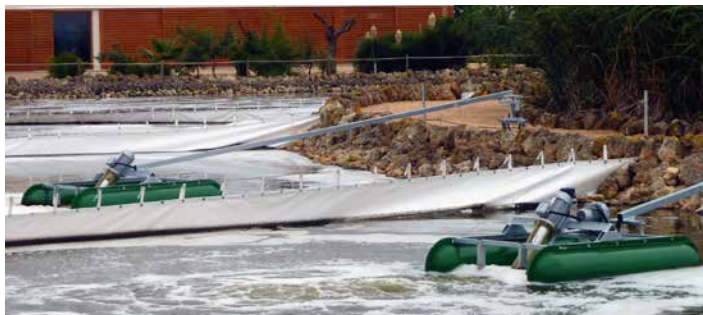
Aerador DualStar sobre flutuadores em um sistema de lagoas de tratamento de efluentes
