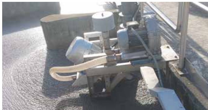
Aireador DualStar con soporte de montaje sobre un puente de máquina
