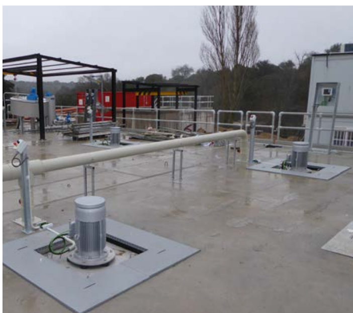
Aireador Centrox con rompe-espuma CX-S en un reactor cerrado
