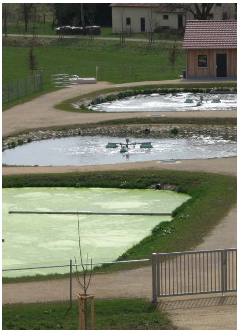
Aireadores de embalses Centrox en una pequeña planta de tratamiento de aguas residuales municipales (Alemania)
