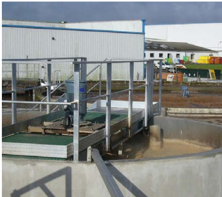
Aireador Centrox con rompe-espuma CX-S montado sobre un puente de máquina
