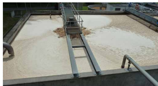
Traitement des eaux usées de l'industrie chimique
