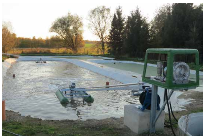
Aérateur DualStar avec compresseur à terre – Fromagerie (Allemagne)
