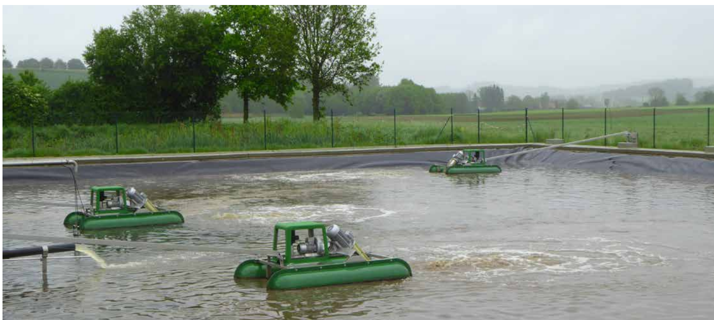
Aérateurs DualStar dans une lagune à système SBR (Allemagne)
