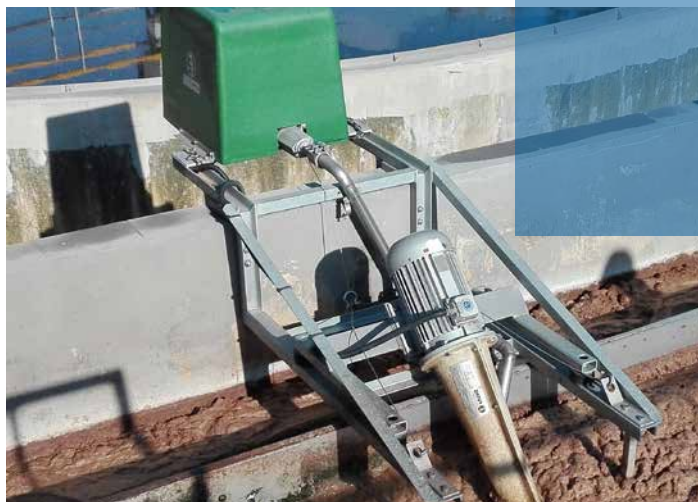
Aération supplémentaire – STEP à boues activées (France)
