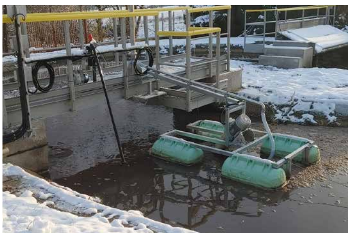
DualStar sur suspension flottante - Eaux usées urbaines (République tchèque)
