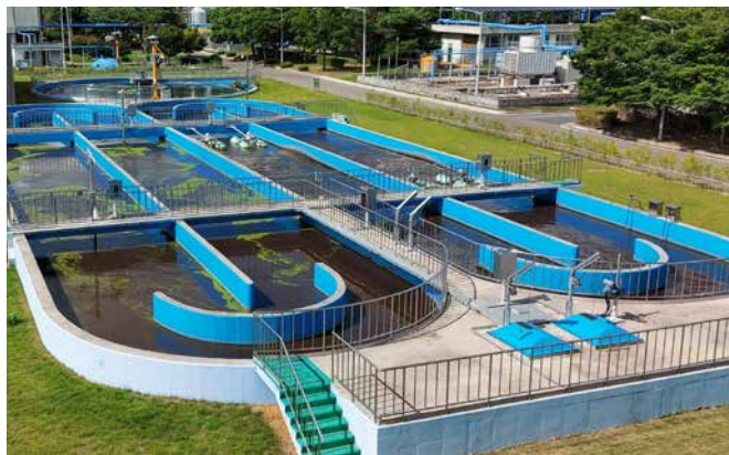
Chenal d'oxydation d'une station d'épuration des eaux usées municipales avec aérateurs OxyStar® (Corée)
