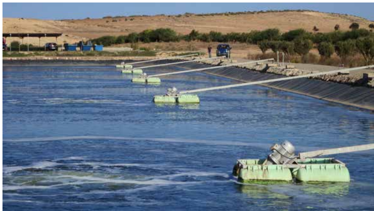
Aérateur OxyStar® sur suspension flottante dans une lagune des eaux usées (Maroc)
