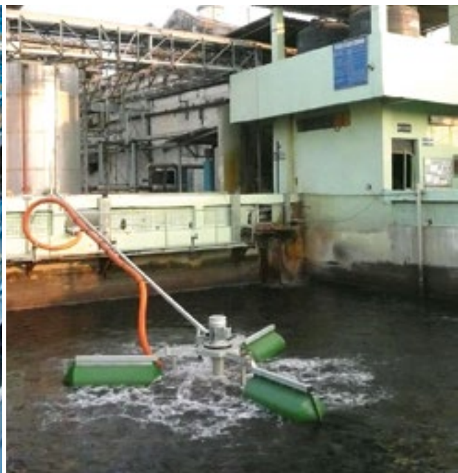
富克斯曝气机用于中和碱性工业废水 (印度印染厂)
