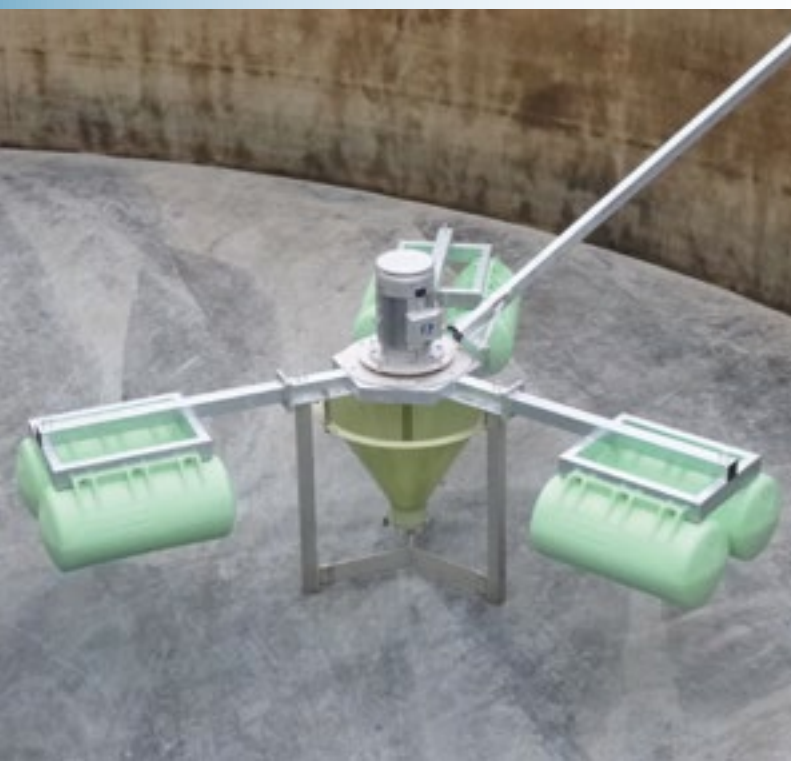
改造后的储泥池用于污泥稳定
