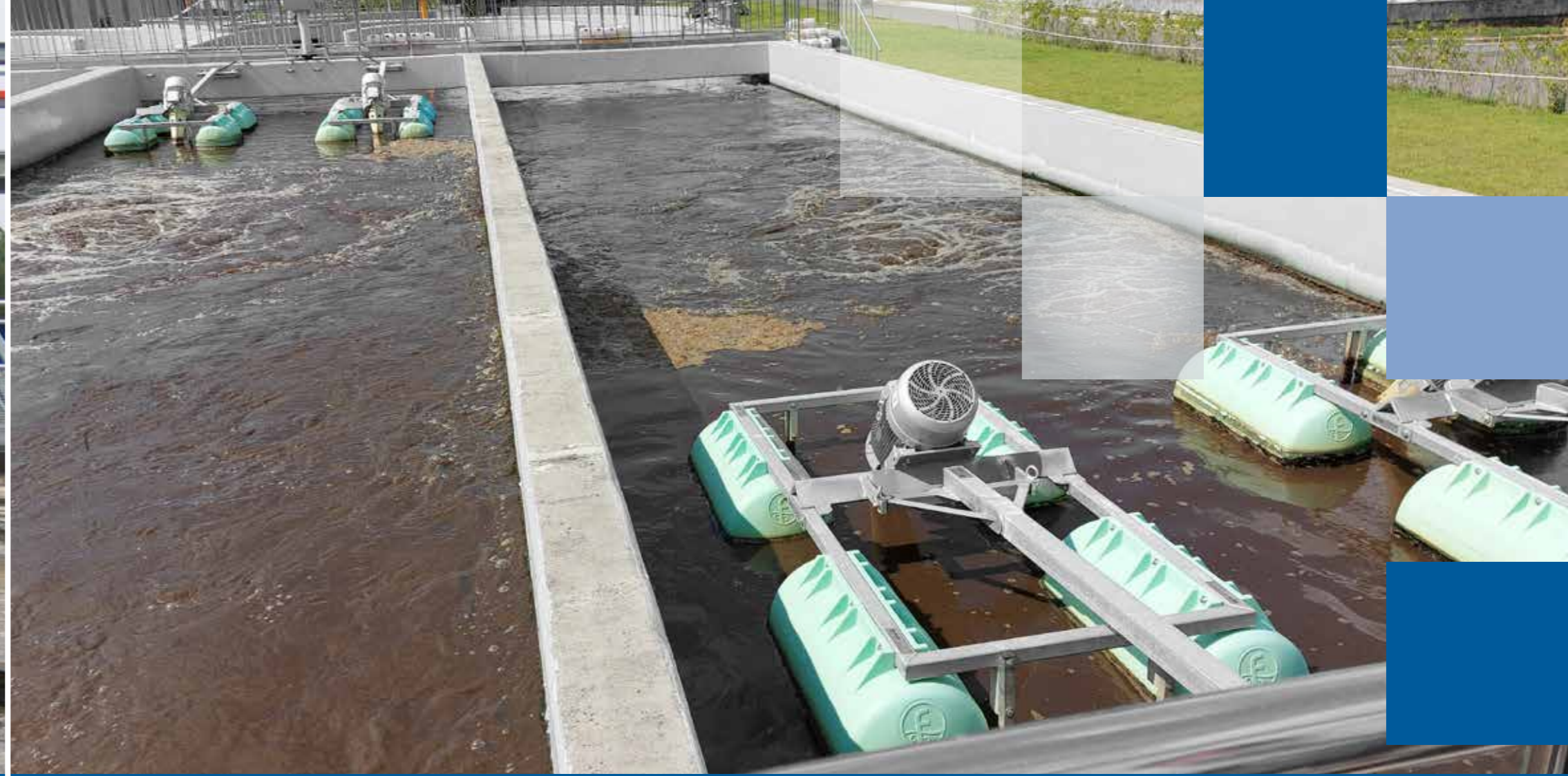
Sustitución de aireadores de cepillo en una PTAR municipal (Corea del Sur)
