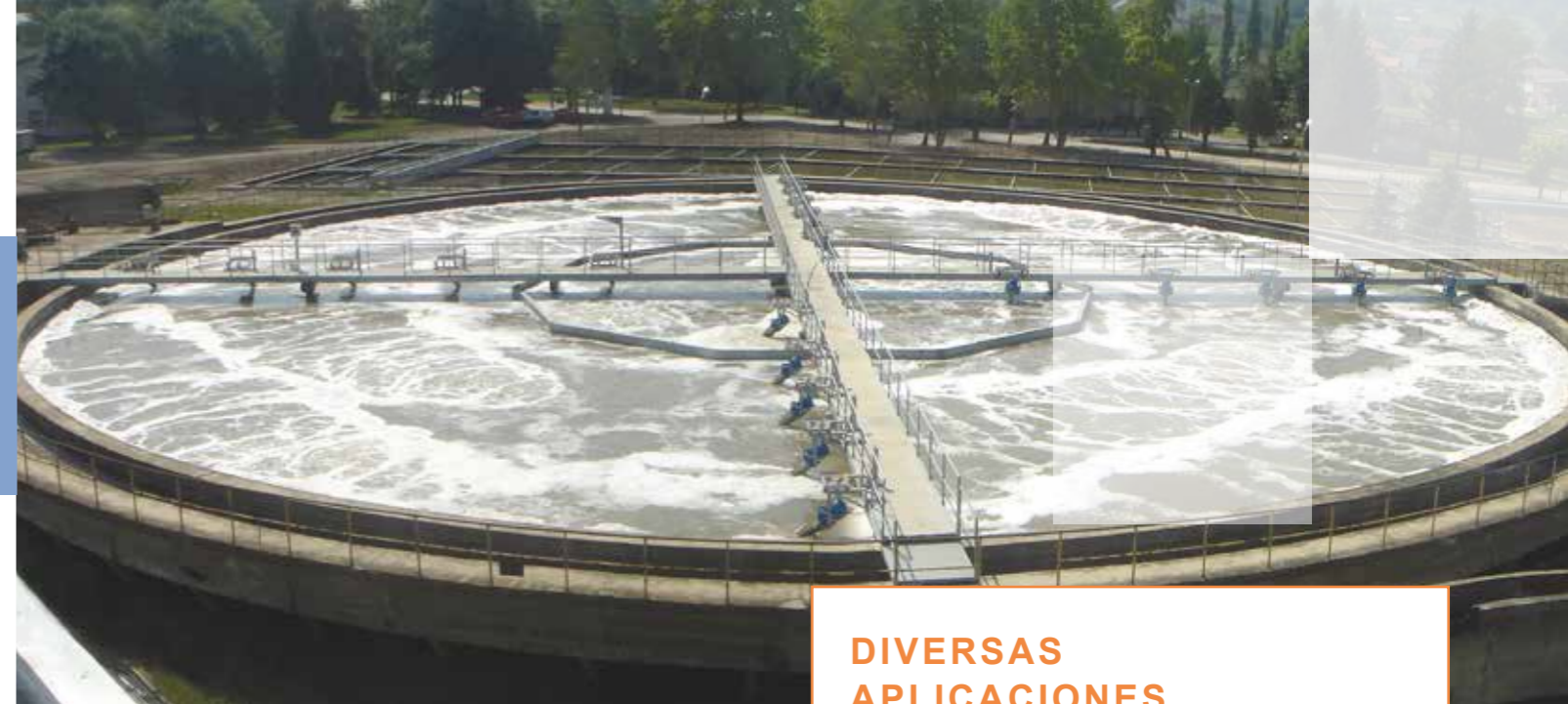
Tratamiento de efluentes de papeleras con aireadores FUCHS (Bosnia-Herzegovina)
