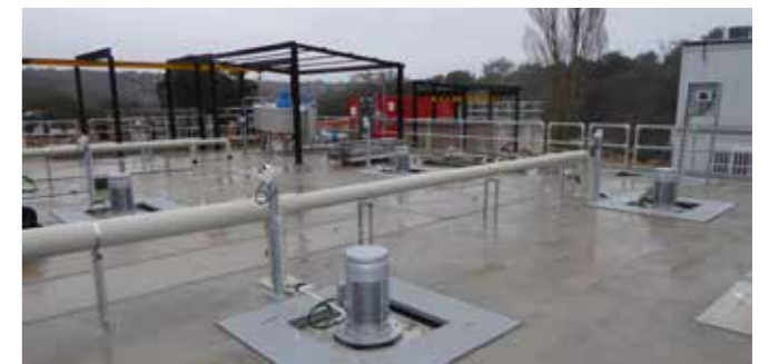
Aireadores FUCHS Centrox con control de espuma para digestión aeróbica (España)
