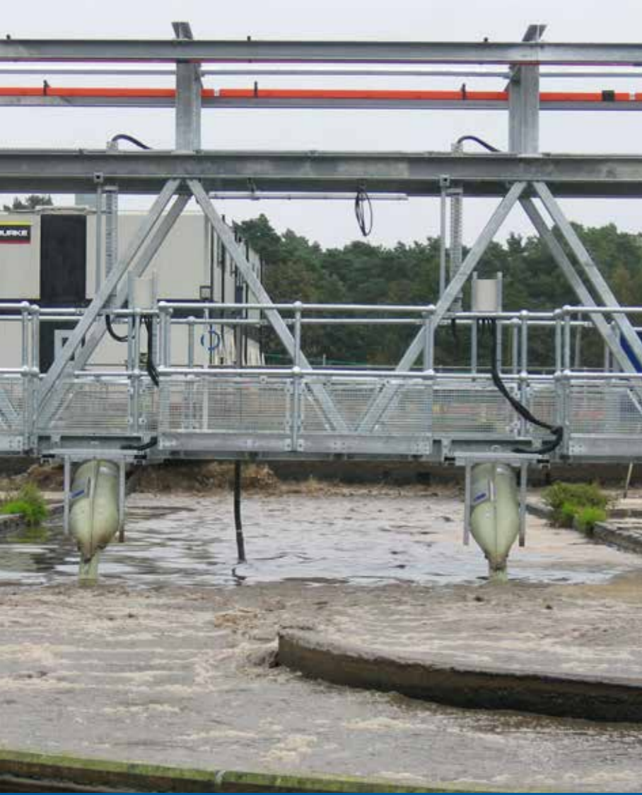
Aireación suplementaria en una zanja de oxidación (Reino Unido)
