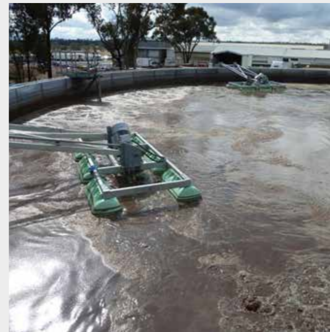
Aireadores flotantes FUCHS en un tanque de lodos activados de un matadero (Australia)
