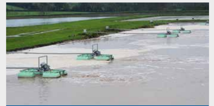
Aireadores FUCHS en una central lechera (Francia)
