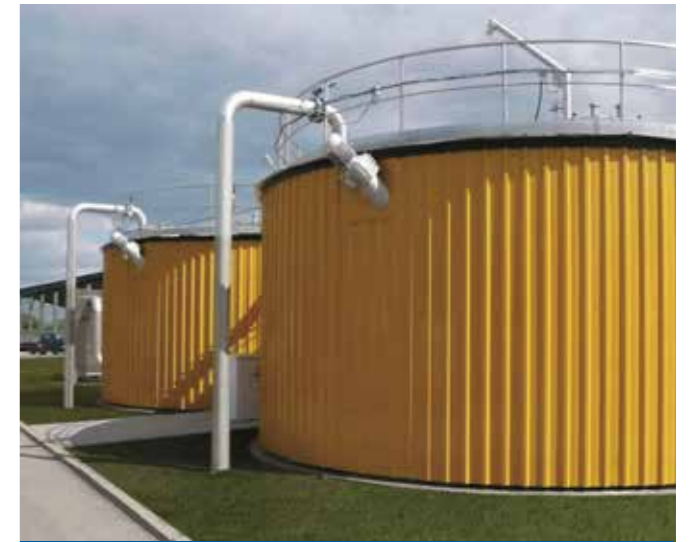
Plantas FUCHS DATA para el tratamiento de lodos de depuración municipales o industriales (Polonia)
