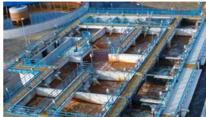
Aireadores OxyStar® para la oxidación del agua de mina (Alemania)
