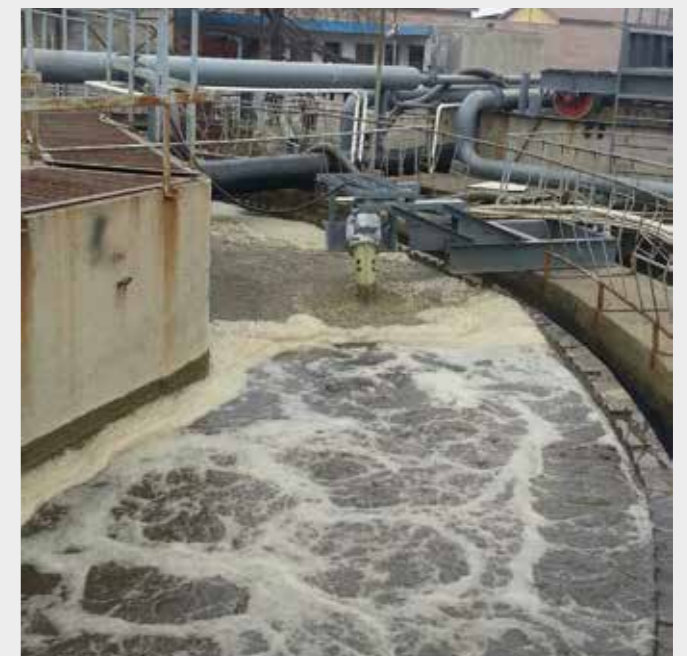
FUCHS Belüfter zur Reinigung von Abwasser aus der Textilindustrie (China)
