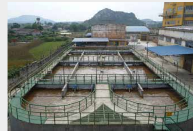
FUCHS Belüfter im Belebungsbecken einer Zuckerfabrik (China)
