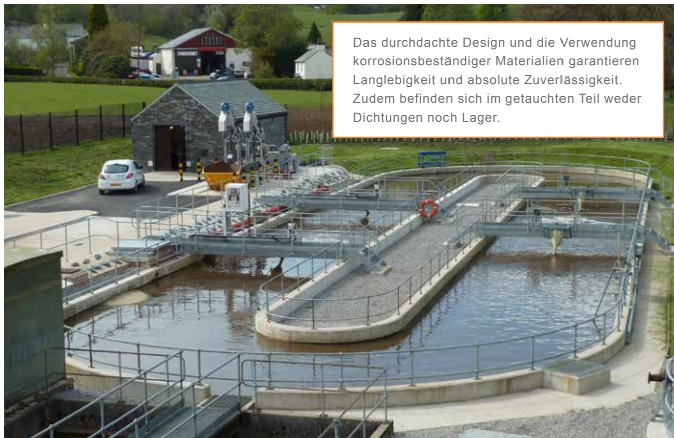
FUCHS Belüfter im Oxidationsgraben einer kommunalen Kläranlage
