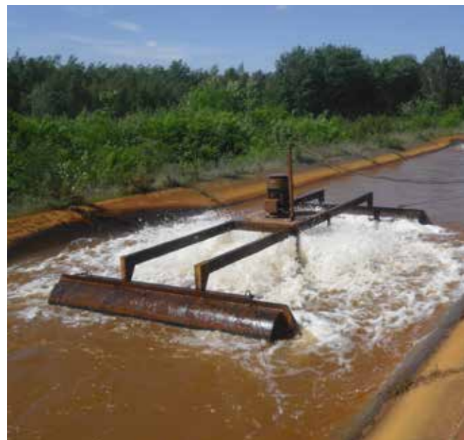
AeroStar Belüfter auf Schwimmern zur Ausstrippung von Kohlensäure
