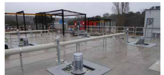
Getrennt aerobe Schlammstabilisierung mit FUCHS Centrox Belüftern mit Schaumeinzug
