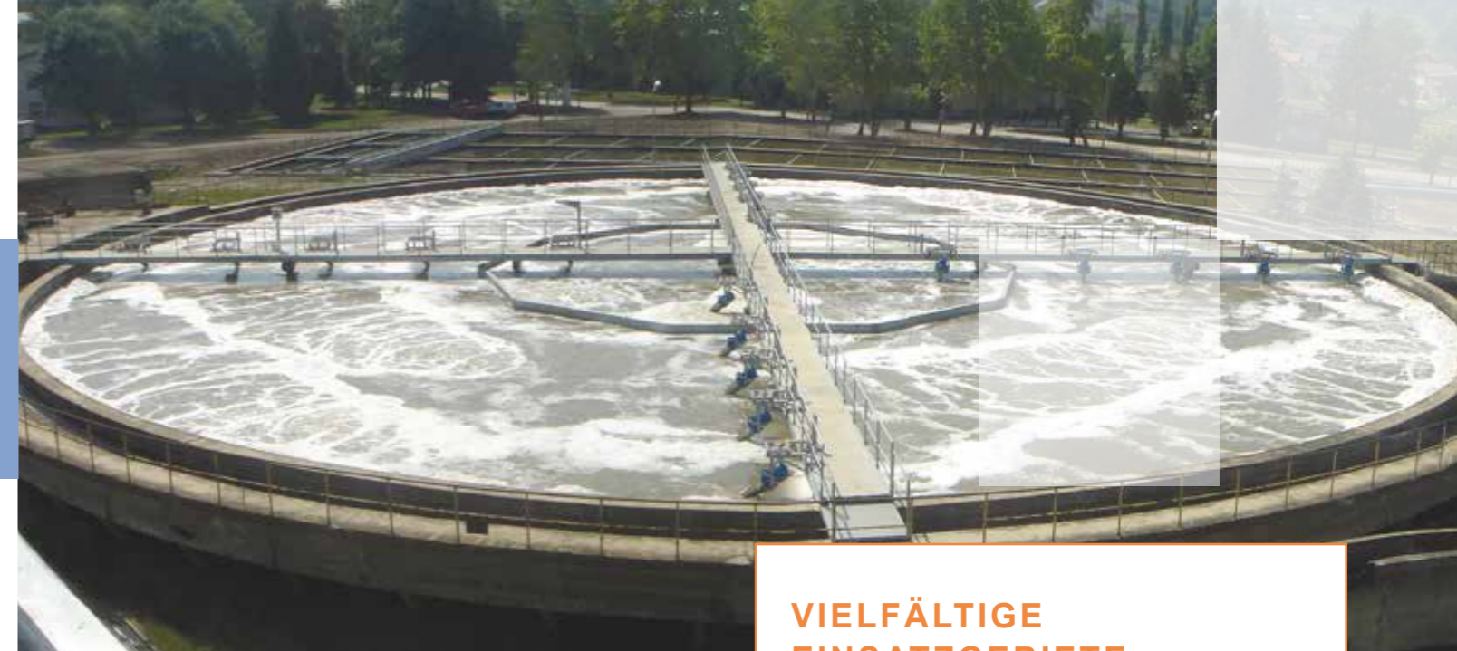
FUCHS Belüfter in einer Papierfabrik (Bosnien Herzegowina)
