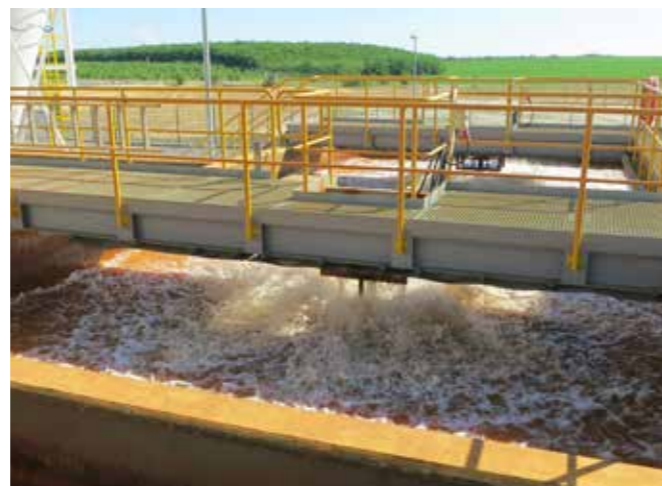
AeroStar Belüfter zur Desorption von CO 2 im Grubenwasser
