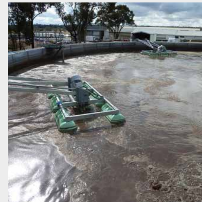
Schwimmende FUCHS Belüfter im Belebungsbecken einer Schlachtereier
