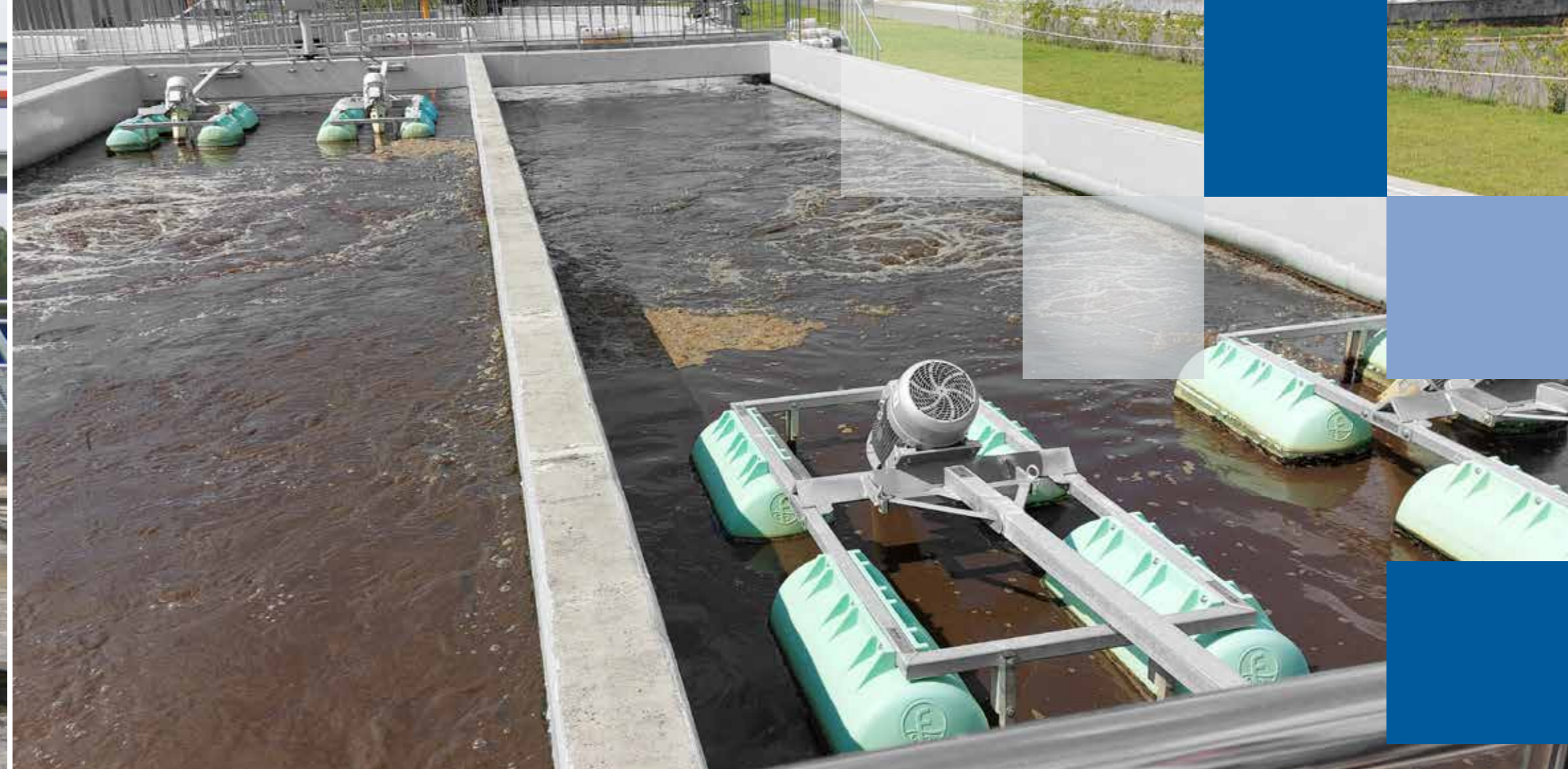
Umrüstung auf FUCHS OxyStar® Belüfter mit niedrigen Betriebs- und Wartungskosten
