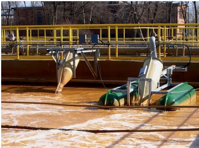
Grubenwasserbehandlungsanlage „Schwarze Pumpe“ (LEAG)
