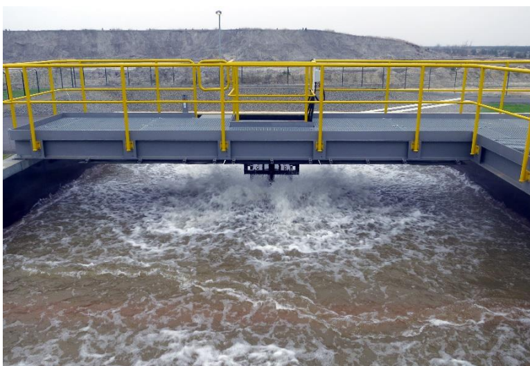
Grubenwasserbehandlungsanlage "Schwarze Pumpe" (LEAG, vormals Vattenfall)
