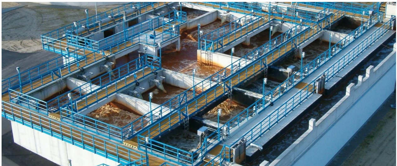
Grubenwasserbehandlungsanlage „Tzschelln“ (LEAG, vormals Vattenfall)
