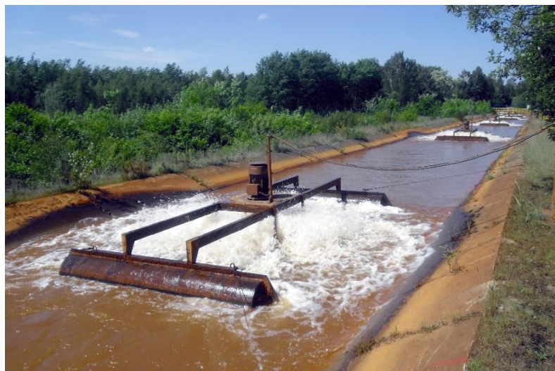
Grubenwasserbehandlungsanlage "Schwarze Pumpe" (LEAG, vormals Vattenfall)
