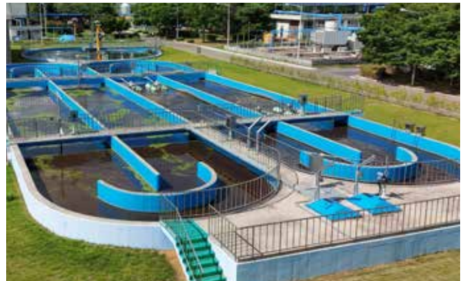
Zanja de oxidación de una EDAR municipal con aireadores OxyStar® (Corea)
