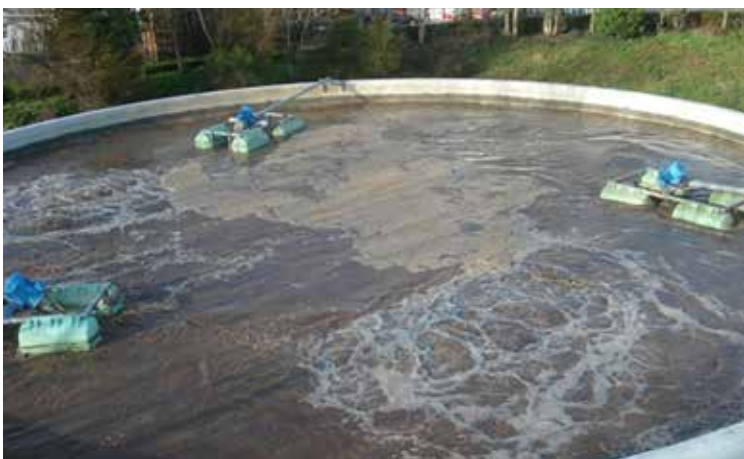
Tanque de equalización circular con aireadores OxyStar® (Francia)
