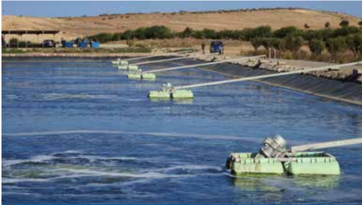
Aireador OxyStar® sobre flotadores en una laguna de aguas residuales (Marruecos)
