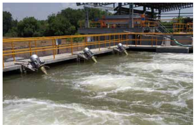
Una aplicación especial de los aireadores OxyStar® es su uso en el tratamiento para la oxidación de agua de mina que contiene hierro
