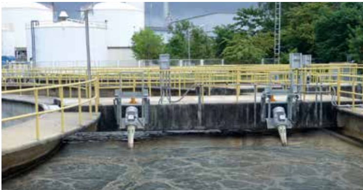
Aireador OxyStar® con soporte de montaje en un tanque de lodos activados de una planta de tratamiento de aguas residuales industrial (Tailandia)
