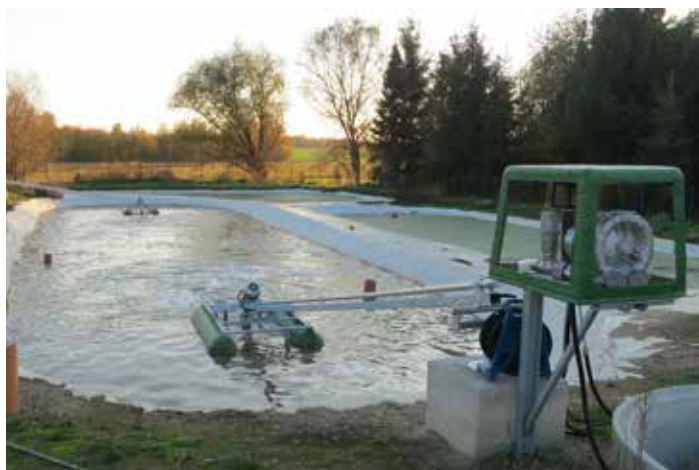
DualStar Belüfter mit landseitigem Gebläse in der Betriebskläranlage einer Käsemanufaktur (Deutschland)
