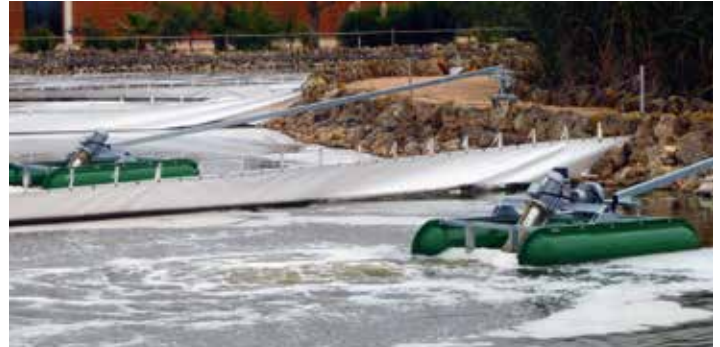
DualStar Belüfter auf Schwimmer in einer Klärteichanlage
