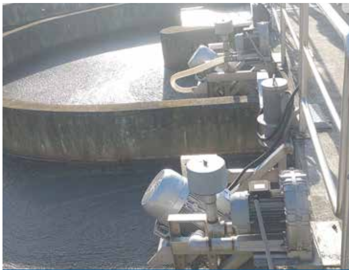
Oxidationsgraben einer kommunalen Kläranlage (Tschechien)
