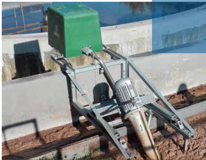
Zusatzbelüftung in einer Belebungsanlage (Frankreich)
