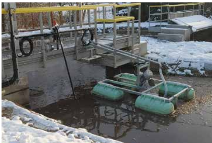
DualStar Belüfter auf Schwimmer in einer kommunalen Kläranlage (Tschechien)
