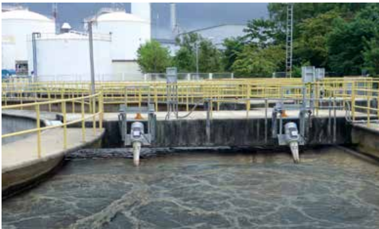
Belebungsbecken einer Industriekläranlage (Thailand)
