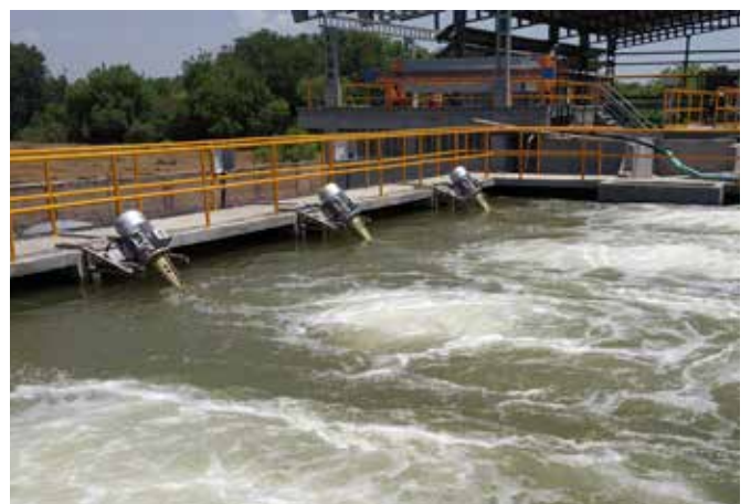
Eine Spezialanwendung von OxyStar® Belüftern ist der Einsatz zur Reinigung eisenhaltiger Grubenwässer
