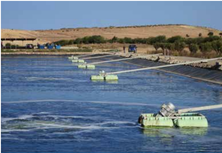
OxyStar® Belüfter auf Schwimmern in einer kommunalen Klärteichanlage (Marokko)
