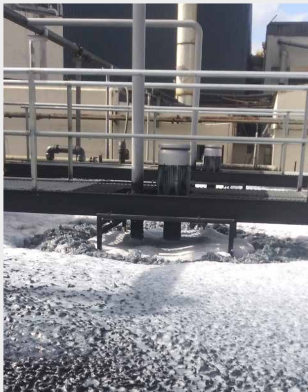
Centrox CX-G sur passerelle
