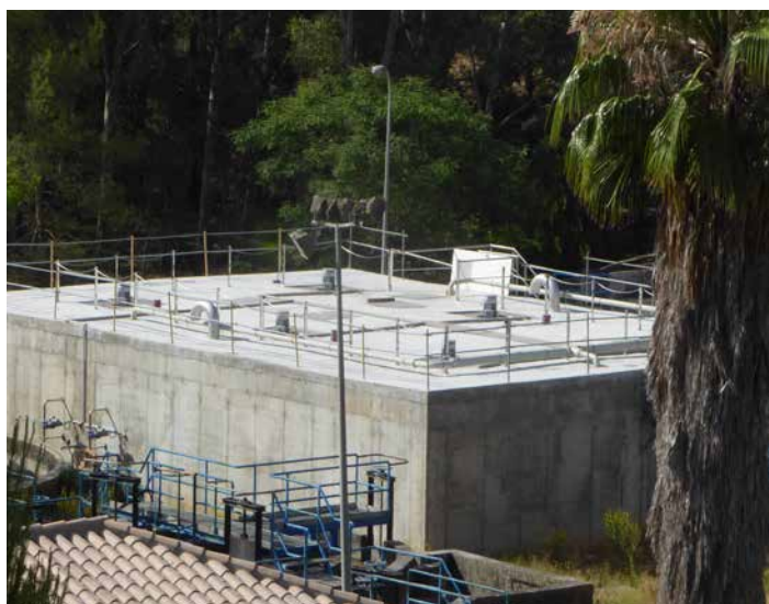
Amélioration des performances d'une station d'épuration communale (Espagne)
