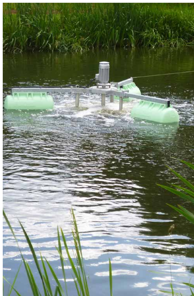
Aérateur Centrox nécessitant peu d'entretien dans une lagune d'eaux usées
