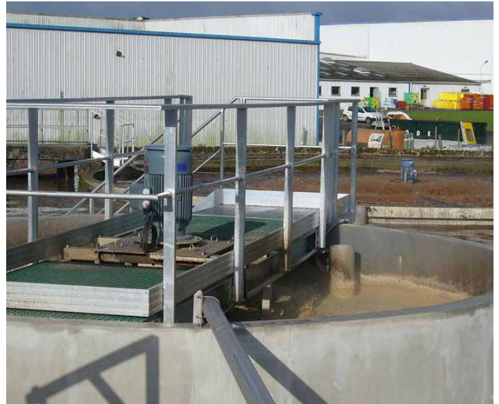
Aérateur CX-S monté sur passerelle
